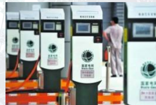
新能源汽车充电桩
