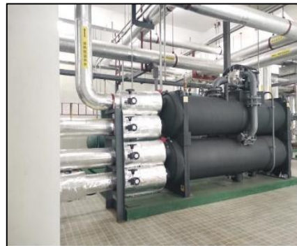
水源热泵回收技术
