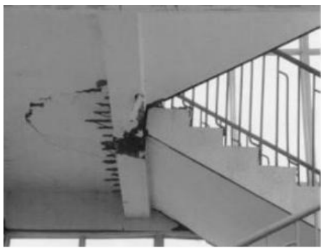
楼梯梯板破坏
