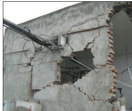
基站机房墙体破坏倒塌
