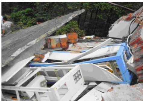
基站机房倒塌砸毁设备
