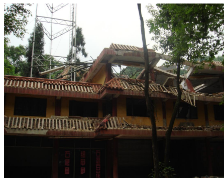
基站机房垮塌
