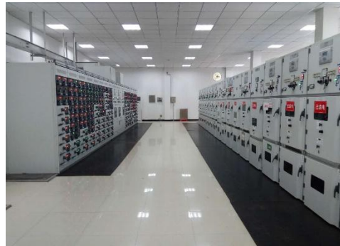
低压柜、高压柜
