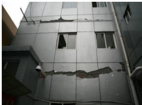
砌体填充墙与梁底发生错动
