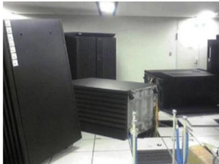
机房设备整体倾倒
