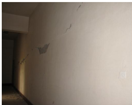
砌体填充墙开裂破坏
