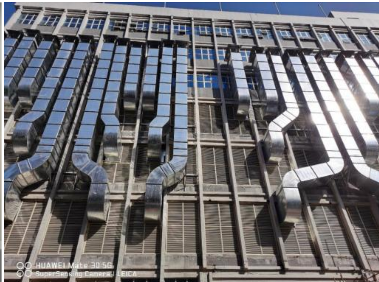
间接蒸发冷却空调机组(AHU)排风侧设置情况
