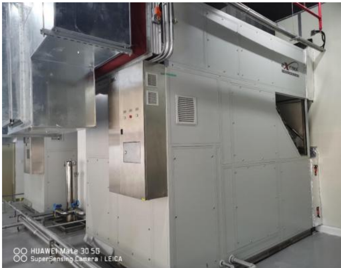
本项目所采用的间接蒸发冷却空调机组（AHU）
